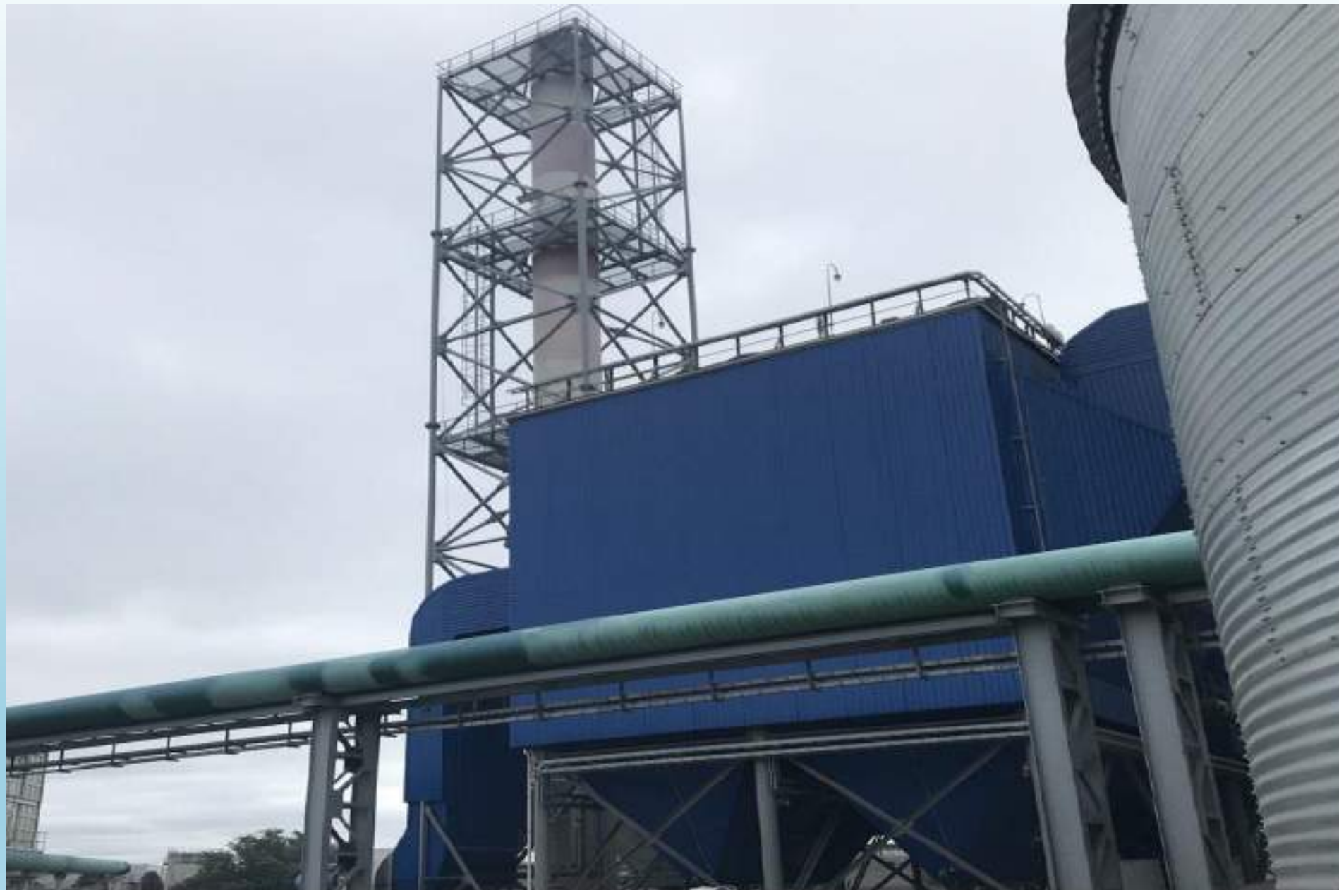
Дымовая труба , электрофильтры к пуску готовы
